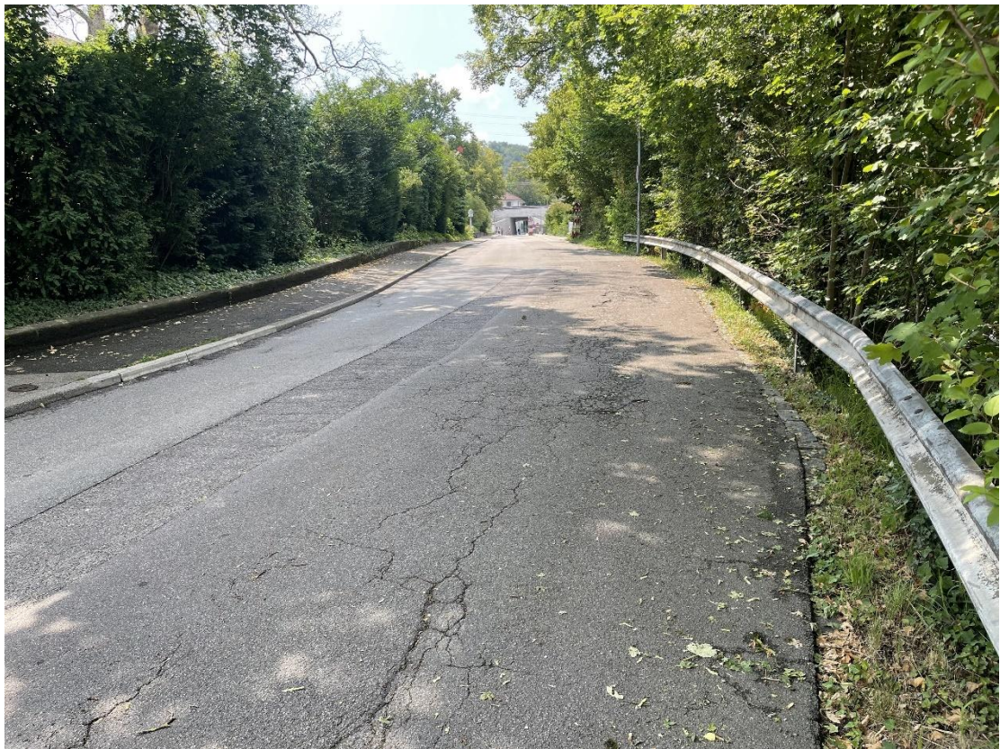
Abb. 1 Strassenzustand zwischen Rheinstrasse und Zufahrt Zentralwäscherei
