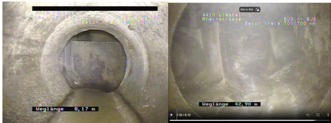
Abbildung 4: Abbildung Link: Ansicht aus Kanalfernsehaufnahme auf Schacht AJ30 (von oben), Abbildung rechts: Ansicht von Schacht BJ2 nach oben Richtung Schacht AJ30 (Leitung Links).
